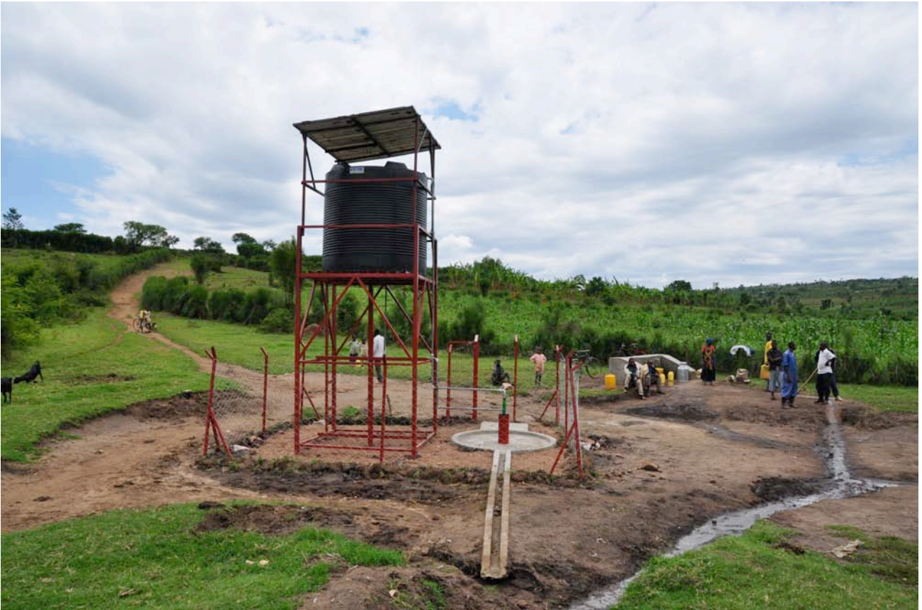
Pozzo con impianto solare - Località RURENGE nel Nord-est del Ruanda
